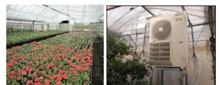
施設園芸ハウス内のヒートポンプ設置状況
