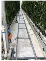
【施設園芸ハウスの内温湯管】
